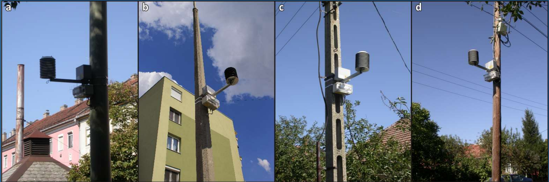
Példák a mérőállomások elhelyezésére (a) acél és (b) beton kandeláberen, (c) beton és (d) fa villanyoszlopon
