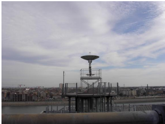
Műholdvevő-állomás a lágymányosi épület tetején.
