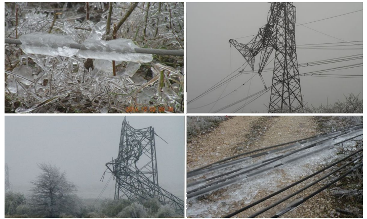
15. ábra: Az ónos eső okozta jéglerakódás, illetve a helyenként 6 tonna plusz terhelés miatt összerokkadt tartóoszlopok Gödöllő térségében. (MAVIR felvételei).
